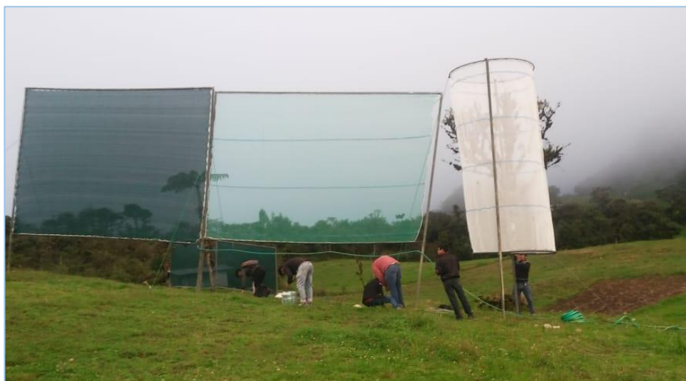
Figura 1. Instalación de mallas atrapanieblas rectangulares y cilíndricas en el centro poblado La Palma en Chota-Cajamarca.
