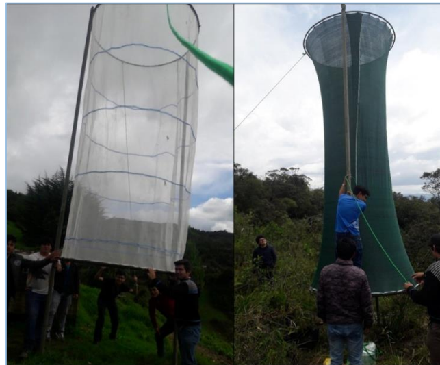
Figura 2. Montaje de mallas cilíndricas tensadas y fijadas en el centro poblado La Palma en Chota-Cajamarca.
